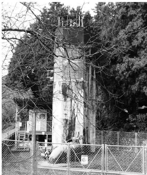
写真7 タワー上部から水を落とす仕組みとなっている
