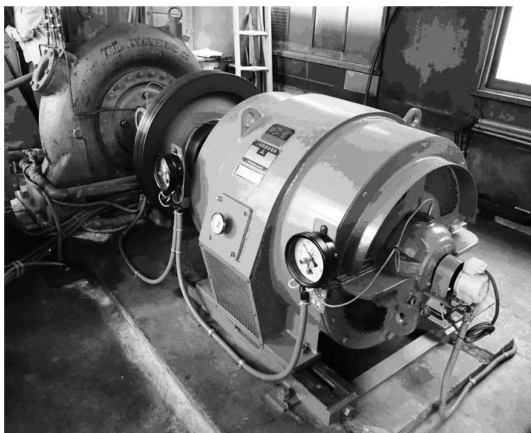
写真5 フランシス型水車（奥）と発電機（手前）
