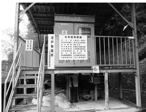
写真6 自動制御運転の河戸発電所
